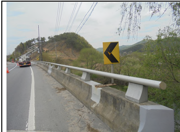
손상현황 • 방호벽 전경
