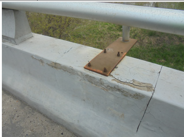
손상현황 • S3 박리(0.5×1.0)
