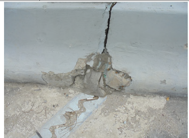
손상현황 • S2 파손(0.5×1.0)
