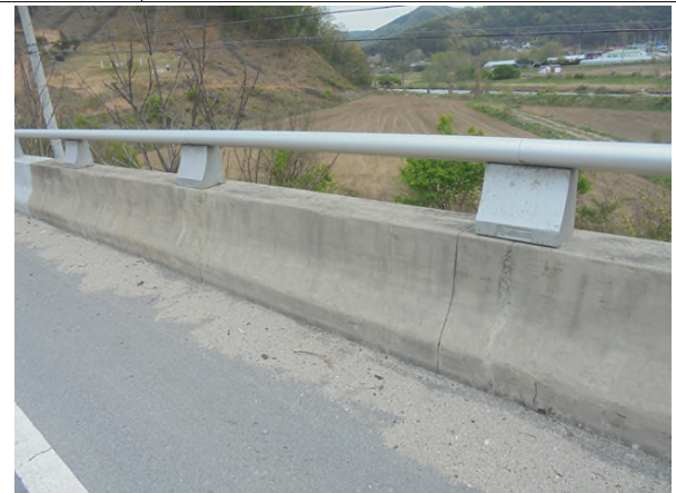
손상현황 • S4 균열(폭 0.3mm미만)
