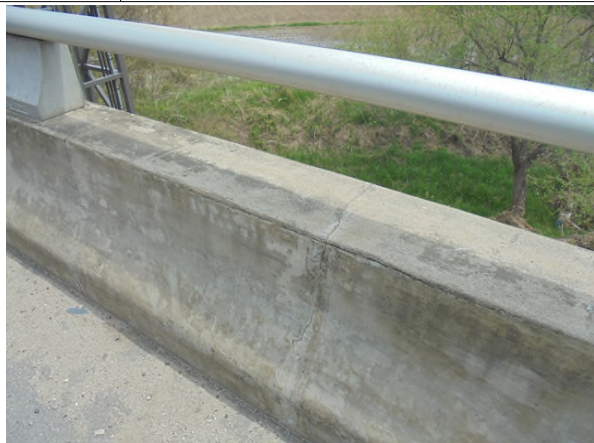
손상현황 • S2 균열(폭 0.3mm이상)
